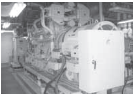
常用発電設備
